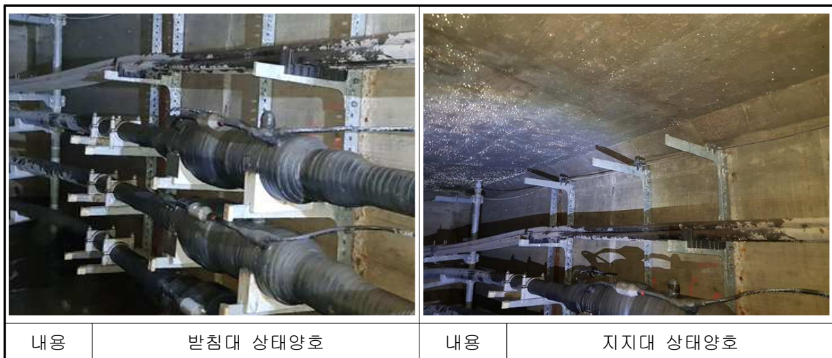
【사진 7.40】 부속 및 부대설비 현황
