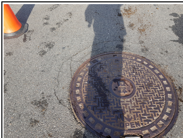
내용 도로포장 아스콘망상균열
