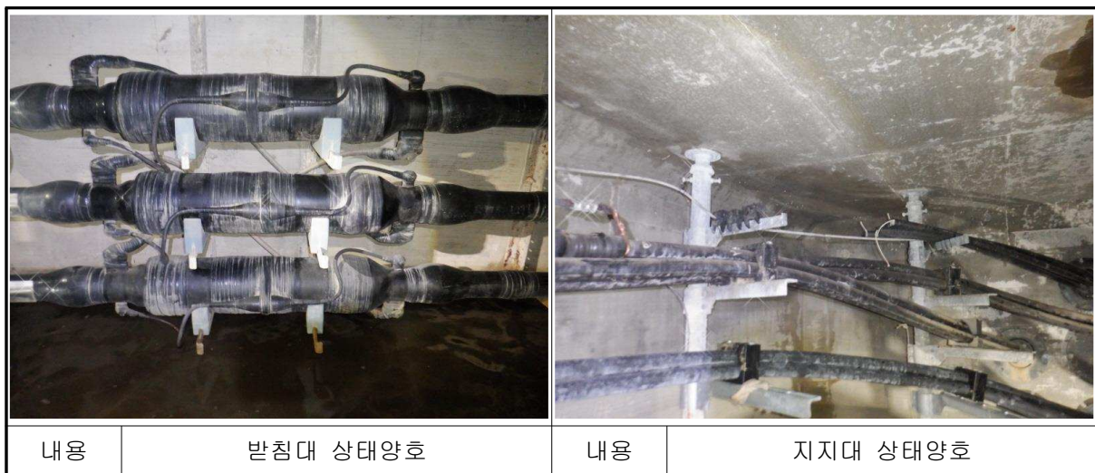
【사진 7.16】 부속 및 부대설비 현황
