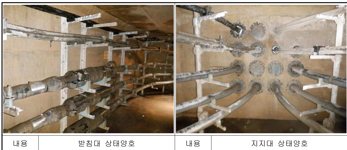
【사진 7.68】 부속 및 부대설비 현황
