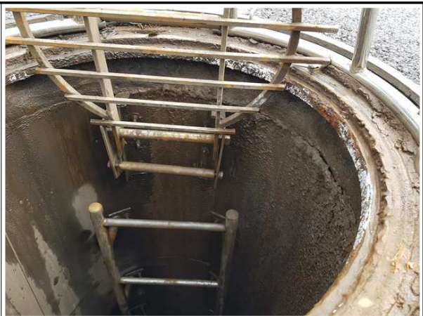
내용 도로포장 안전손잡이 볼트유실
