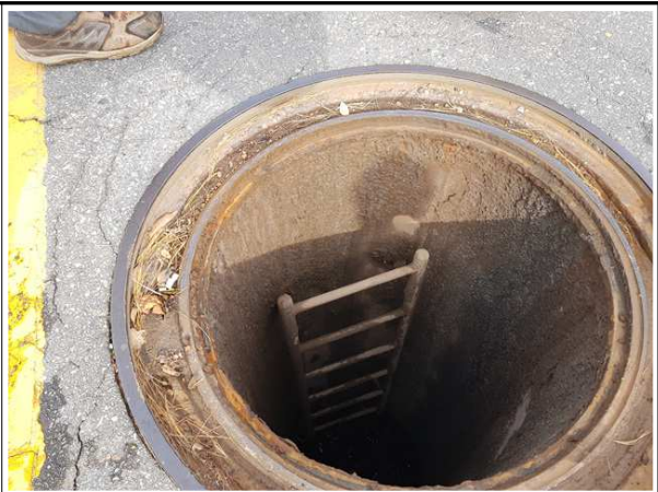
내용 추락방지시설 안전손잡이 탈락
