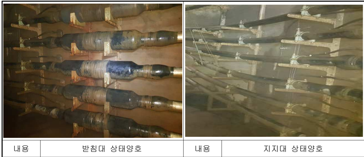
【사진 7.44】 부속 및 부대설비 현황
