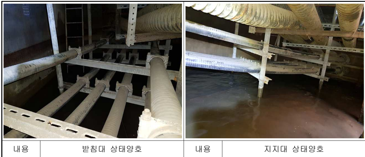
【사진 7.32】 부속 및 부대설비 현황
