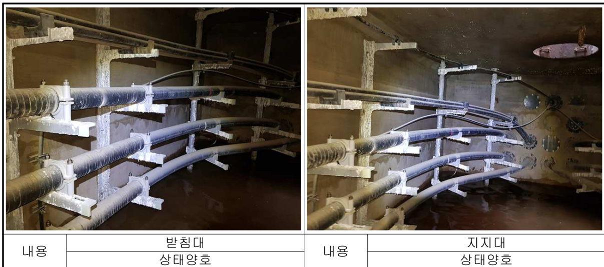
【사진 7.28】 부속 및 부대설비 현황
